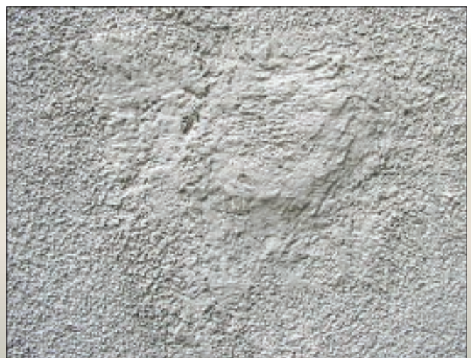
Дефекты внешнего вида из-за неправильного монтажа лесов и последующей заделки мест крепления.
