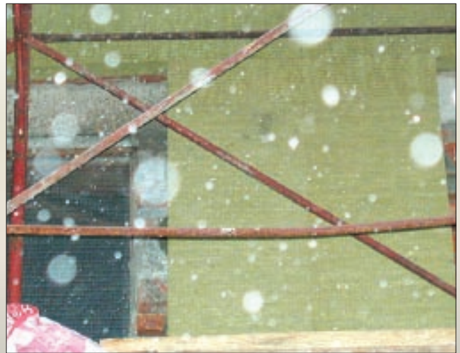
Полное отслоение теплоизоляционного покрытия и частичное обрушение теплоизоляционных плит при монтаже системы в зимнее время года (температура воздуха ниже +5 °С) на холодную поверхность, покрытую инеем. Работы проводились без устройства тепловой завесы.
