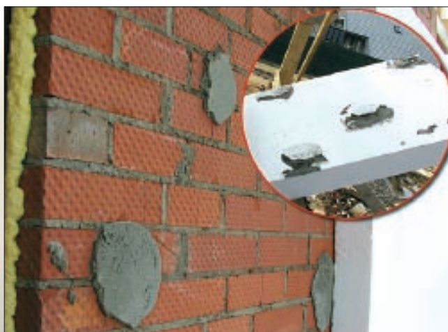
Приклеивание теплоизоляционных плит велось на неподготовленную поверхность керамического кирпича с нарушением технологии приклеивания плит.
