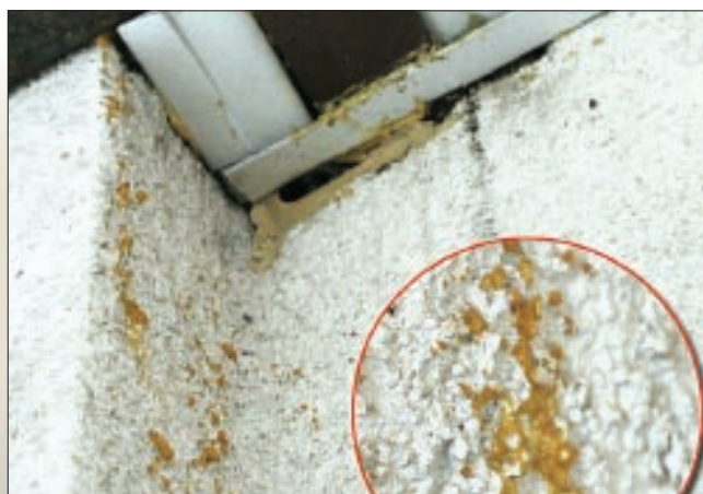
Пятна ржавчины, вызванные коррозией элементов механического крепления и кронштейнов навесного оборудования. Металлические детали, остающиеся под системой и проходящие сквозь нее, не были подготовлены должным образом.
