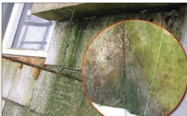
Монтаж теплоизоляционных плит проводился с большими перерывами без устройства противоосадочного укрытия, вследствие чего произошло намокание и заплесневение смонтированных плит. Дальнейший монтаж системы теплоизоляции велся без дополнительной просушки, подготовки поверхности, удаления грибковых и плесневых поражений.
